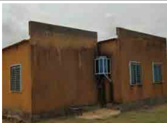
■ Photo-9: Réservoir d'eau installé sur le mur extérieur L'eau puisée dans le forage est versée à la main dans le réservoir.
