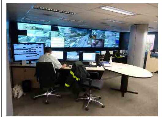
ECOVIAS の交通管制センター 1
