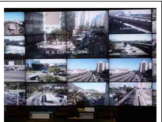
交通管制センター2
