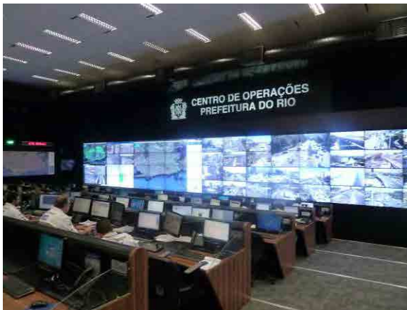
写真 3.2-1 統合管制センター内部
