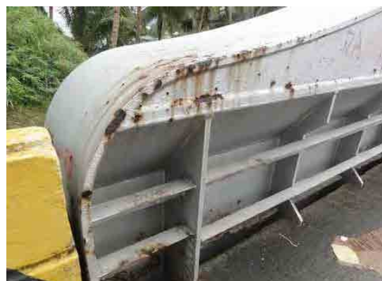
桁端部に発生した錆
