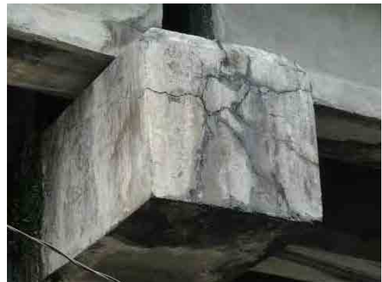
橋脚ブラケット先端のひび割れ
