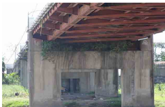
支承付近の植物は取り除く必要あり。
