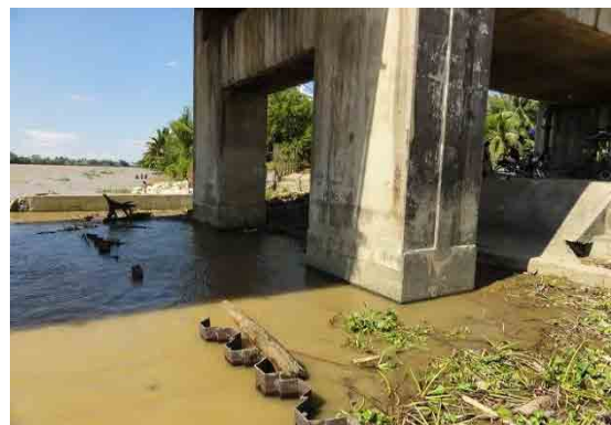
左岸側の橋脚プロテクション破損部
