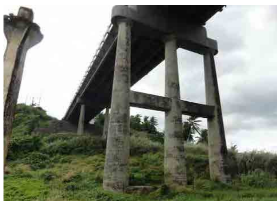
レイテ本島側の橋脚。鳥居のように上細りし、橋軸方向の揺れに対して弱そうである。
