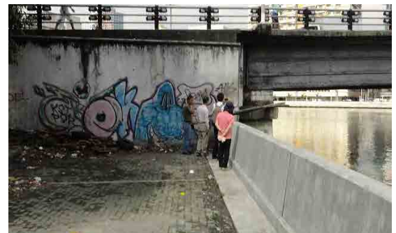
側径間端部へのアプローチ困難
