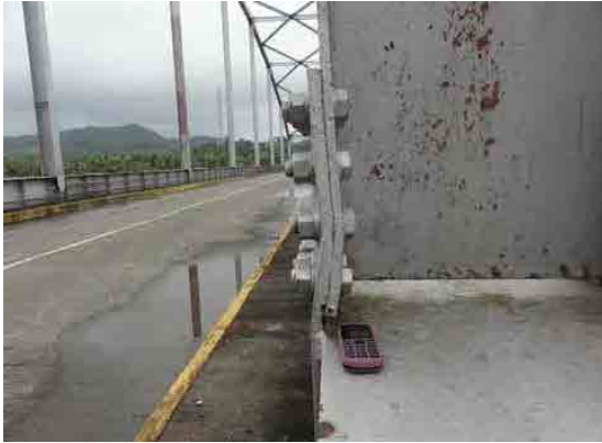
ボルト添接板部分に曲げ歪みが発生
