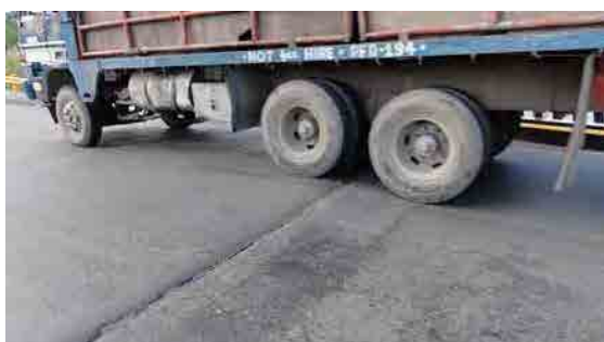
アプローチスラブと橋台に隙間がある。
