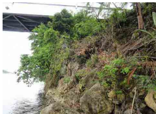
レイテ側橋台下の岩盤は緩んでおり、地震による崩壊が懸念される。
