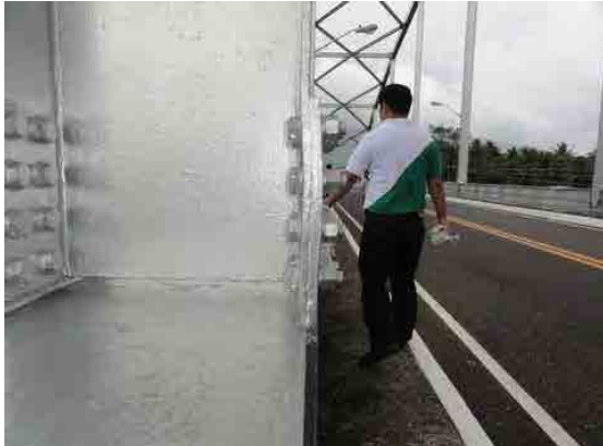
ボルト継ぎ目付近の鋼板が歪んでいる。
