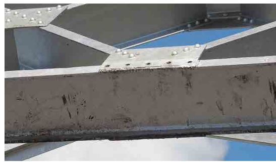
損傷後に取り替えられた部材（リベット→溶接）
