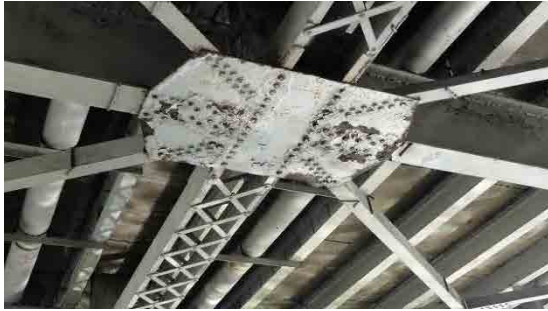
腐食したガセットプレート
