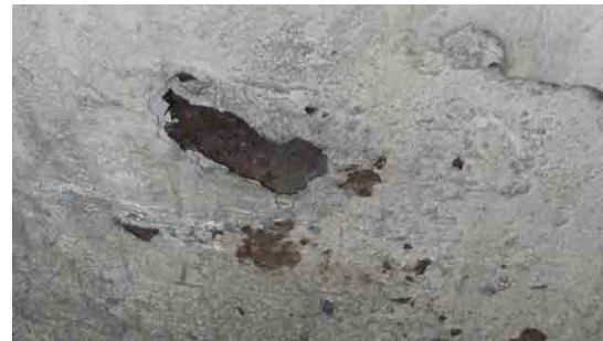
ただし、裏側で立小便による腐食がみられた。
