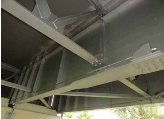
耐震補強の連結ケーブルが設置済み
