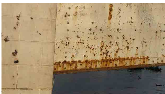
桁端部の腐食状況（中程度）
