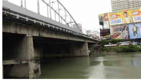
ゲルバー吊り桁に特別な垂れはみられない。
