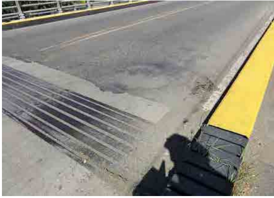
グースアスファルトの損傷が目立つ。
