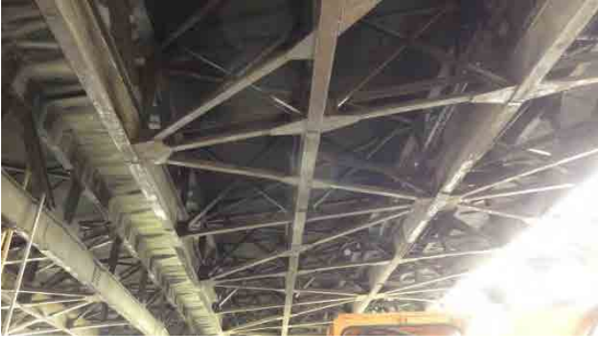
トラス主部材はほとんど無塗装に近い状態
