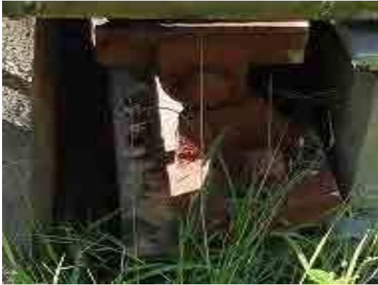
可動側ロッカー支承の過大な転び
