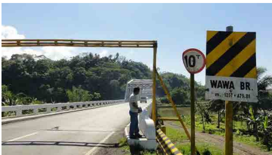
一応、荷重規制10tの標識がある。
