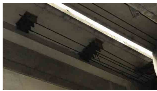
耐震ケーブルが健全な位置
