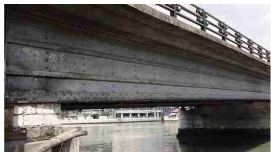
全体に少し塗装の劣化がみられる。
