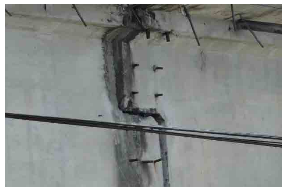
ゲルバー掛け違い部には耐震ケーブルは設置されていない。
