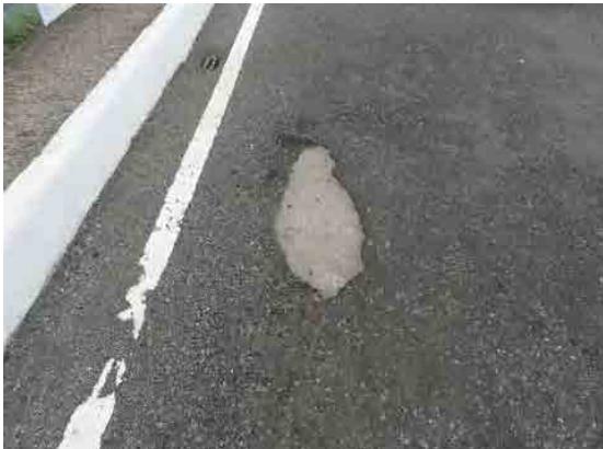
アスファルト舗装のポットホール
