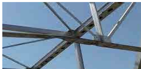
ブトゥアン方向に向かうトラックにより損傷を受けている。
