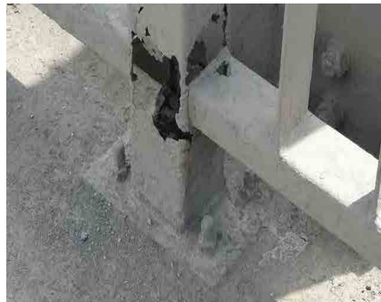
鋼製高欄の腐食状況
