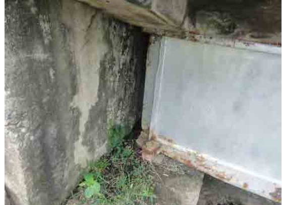
レイテ側アプローチ桁橋端に生じた錆
