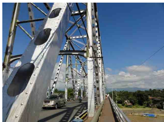
荷重規制15tの標識がある。
