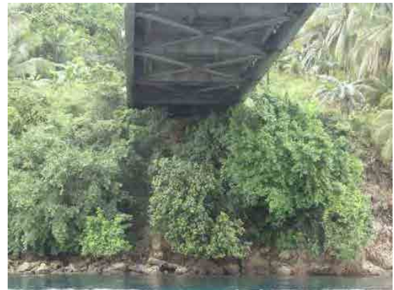
レイテ側橋台下の状況。緩んだ岩盤が地震時に海へすべる可能性がある。
