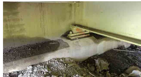
耐震性を考慮したゴム支承への交換が必要
