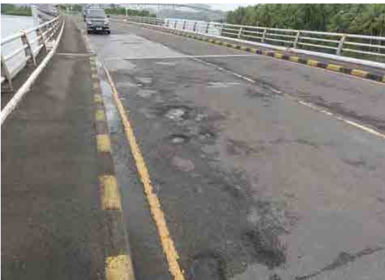
サマル側桁橋の一部で舗装ポットホールが発生
