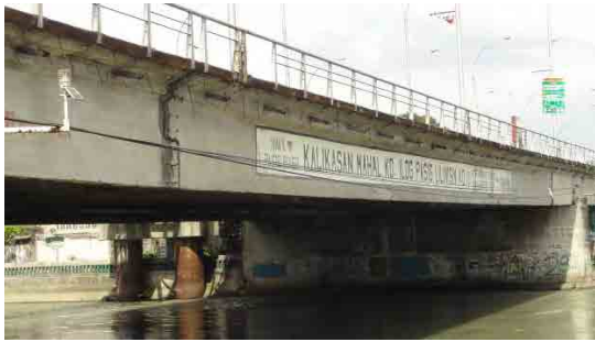
ゲルバー吊り桁部に垂れ下がりがみられる。
