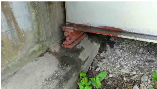
鈑桁部支点上支承の過大な転び
