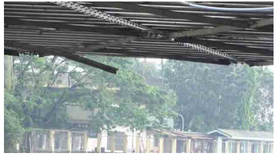
船舶通過時の接触により損傷した部材
