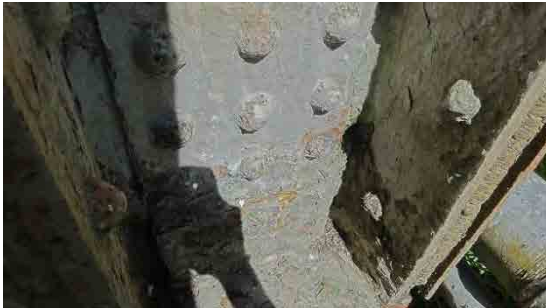
支点上補強材のリベットの頭が腐食により欠損
