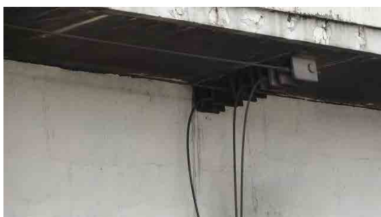
耐震ケーブルが切れた位置詳細
