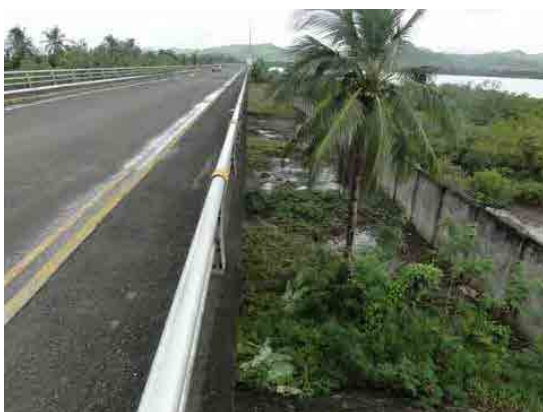
アプローチ部分は進入禁止になっている。 (サマール側アプローチ)
