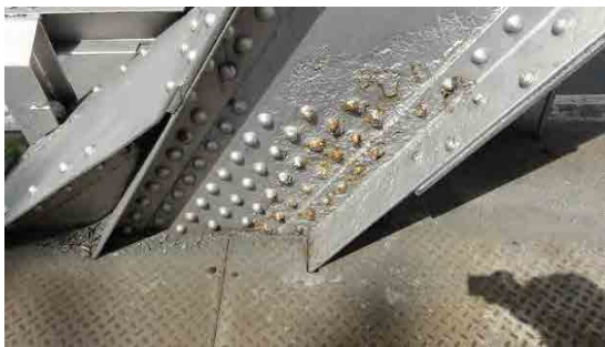
立小便による腐食したリベット
