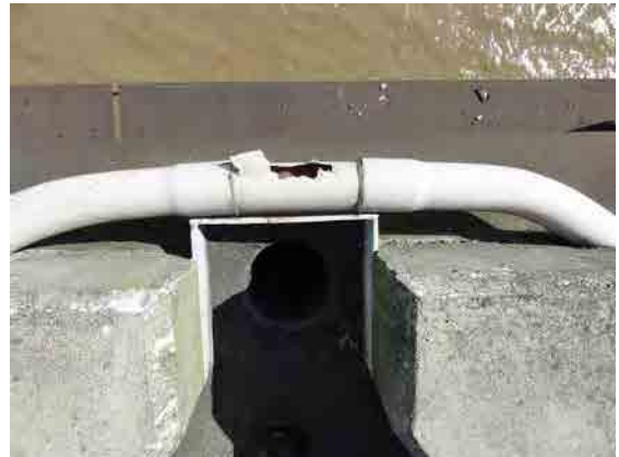
照明用ダクトが破られ銅線が盗まれている。
