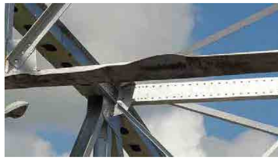
木材運搬トラックの衝突による部材損傷
