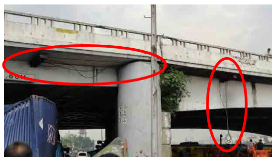
追加された耐震ケーブルが切られている。
