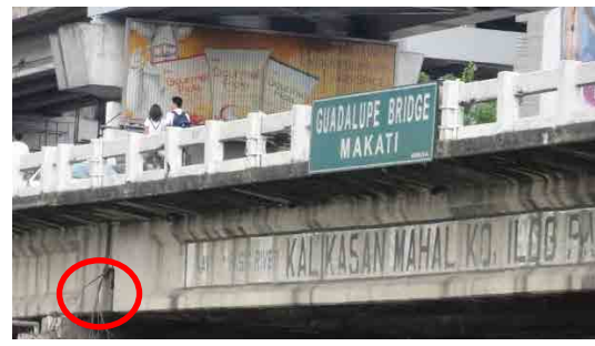
ゲルバー掛け違い部には耐震ケーブルは設置されていない。
