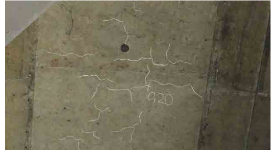
床版クラック調査がなされていた
