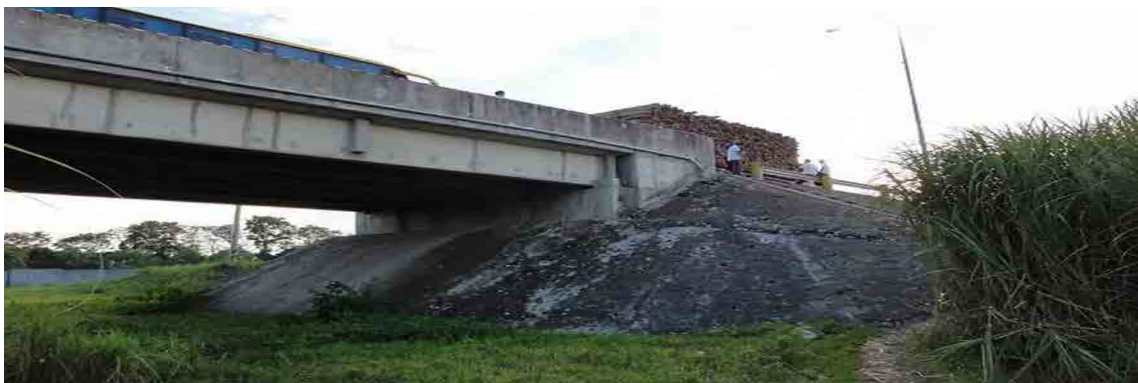
橋台を囲むスロープとアプローチが沈下している。 橋台は杭基礎で支持されているため沈下していない。
