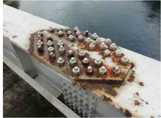
添接板、ボルト結合部分の錆が著しい。
