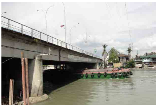
ゲルバー吊り桁部に垂れ下がりがみられる
