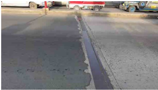
重ねタイプ伸縮装置の一部損傷
