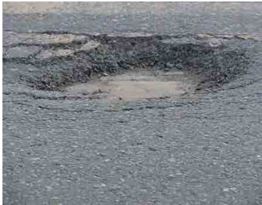
鋼床版の鋼板表面が見えるポットホール
