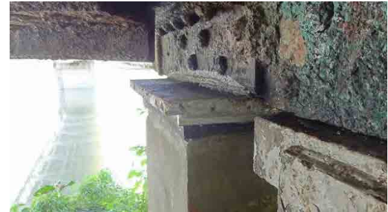
支点上裏側部材は塗装されていない。
