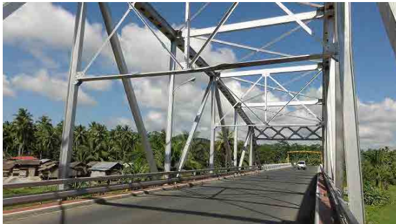
Wawa 橋は、トラス橋2連と鉸桁から成る。建築限界が約4.2mと不足しているため木材運搬トラックの接触で複数の部材に損傷がみられた。
