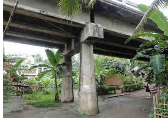
アプローチの PC 桁を支える橋脚構造。耐震補強はなされていない。桁連結もみられない。本格調査で耐震補強検討が必要。
