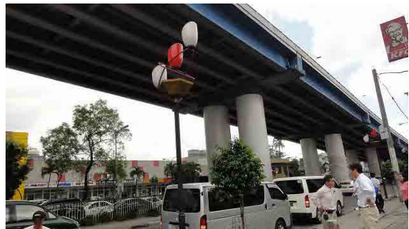
メトロマニラ市内橋梁調査の実施 パッシング川に架かる代表的な橋梁及びフライオーバーの耐震補強工事の実態調査を現地にて確認した。
