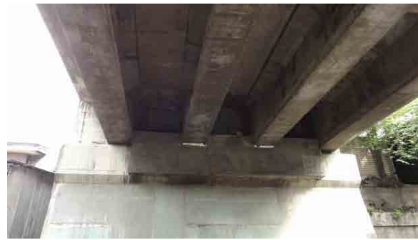
PC4 本主桁端部耐震コンクリートブロックの設置状況
