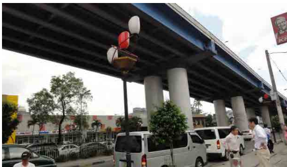
MENDIOLA Flyover は耐震補強のため橋脚に鋼板巻立て補強がなされたフライオーバーである。
