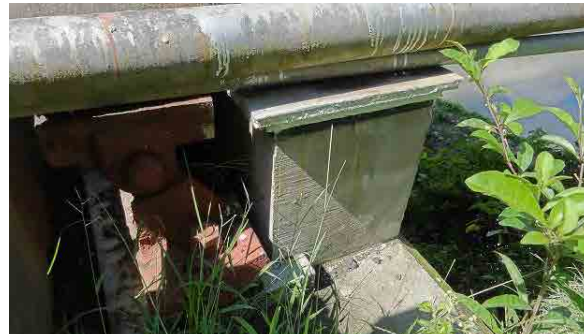
トラス橋端部支承が傾き、コンクリートブロック設置による応急復旧がなされていた。このため、車重10t規制中であった。
