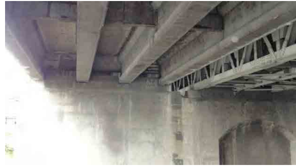
拡幅部 PC4 主桁と鋼トラス桁 10 本構成。3 径間鋼トラス橋と拡幅部ゲルバーヒンジ PC 桁橋。
