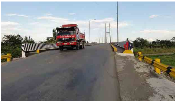
第2Magsaysay 橋は2007年に完成した新橋で本体は問題ないが橋台アプローチ部の沈下と舗装の劣化が主な問題である。
