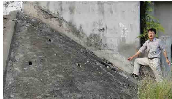
橋台アプローチ部の沈下（約50cm沈下）によりこれまでに2回舗装のオーバーレイを繰り返しているが沈下は止まっていない。
