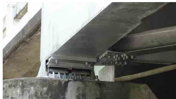
可動支承は地震に脆弱なローラー支承である。
