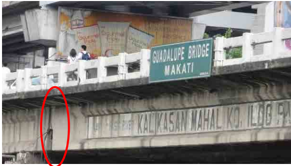
GUADALUPE 橋は、C-4 線上 (EDSA) にある。橋長は 114m の橋梁である。ゲルバー掛け違い部には耐震ケーブルは設置されていない。
