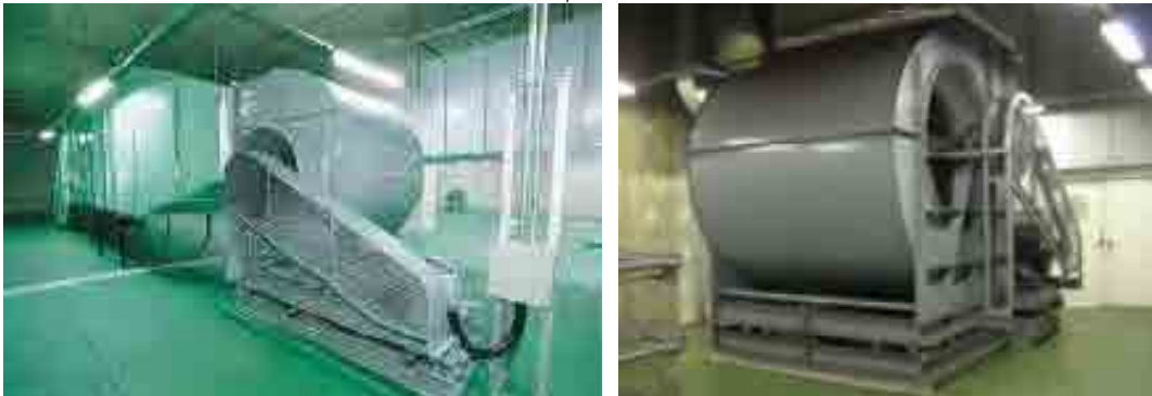
شكل 4- 2 عادم الهواء بالنفق
