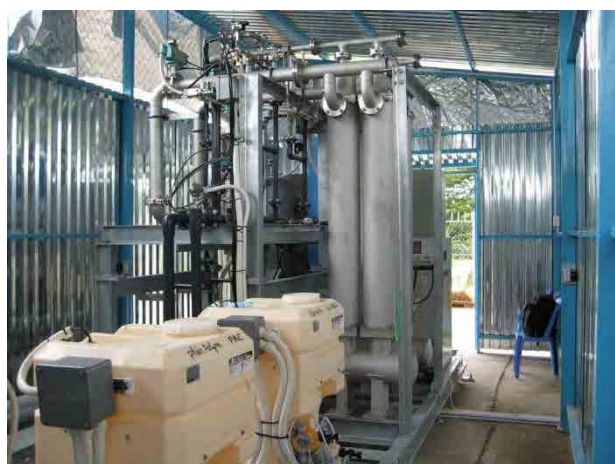
図 5-4 小規模セラミック膜ろ過浄水装置 (浄水量 240m 3 /日)
