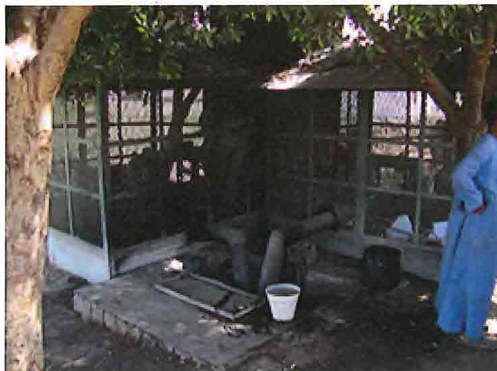
支線水路水利組合 (BCWUA) の管理するポンプ場 (Beni Ebeid)
