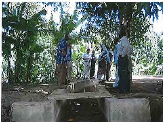
運営・維持管理ガイドラインの実証事業を行った Mkindo 灌漑スキーム（実証事業にて補修した水路と水利組合のメンバー）
