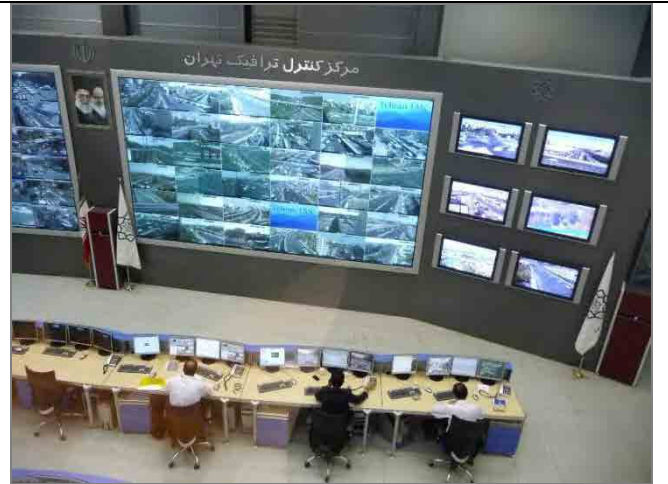
テヘラン市交通管制センター。600 か所の監視カメラと延べ 700km の光ファイバーで交通状況の監視と信号の管理等を行っている。
