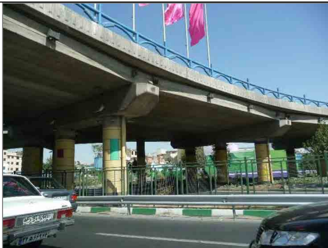
高速道路網には、立体交差が多数存在する。TMMOは240橋梁の診断を実施している。
