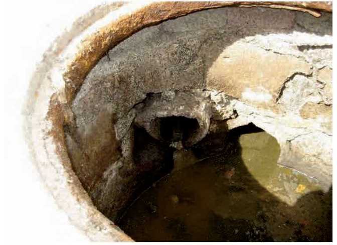
Conduites en amiante-ciment endommagées (Beja)
