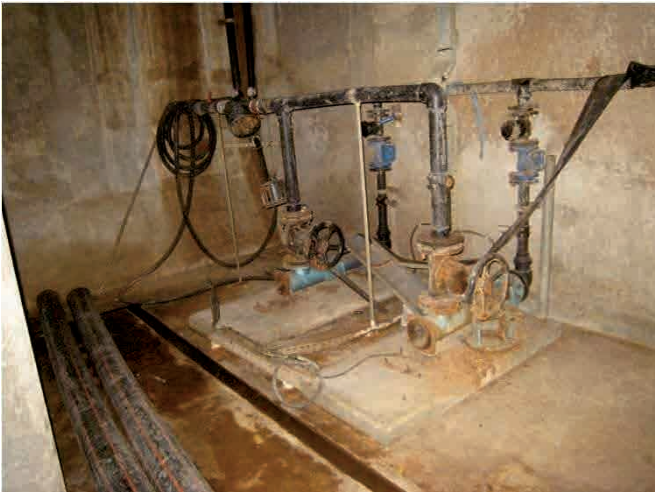
Pompe hors service (STEP de Béja)
