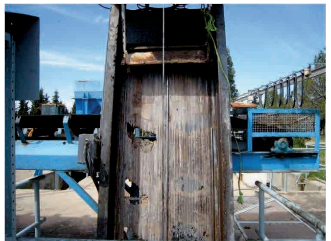
équipement hors service: dégrilleur (STEP de Medjez el Bab)
