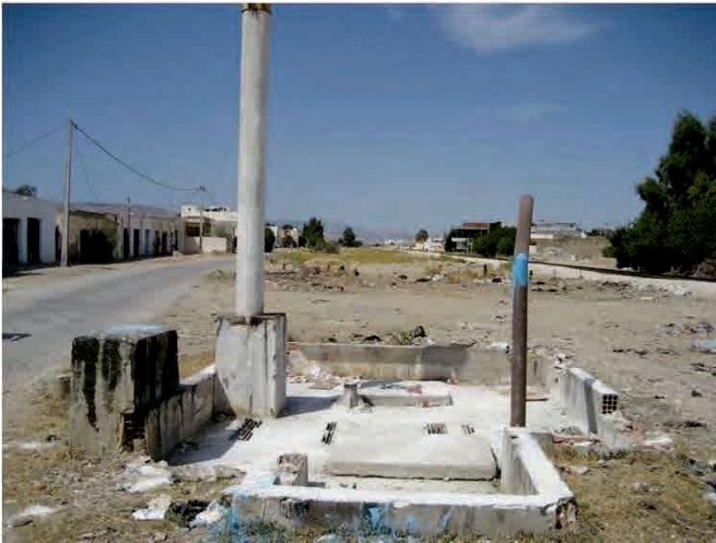
Station de pompage existante (Jendouba)
