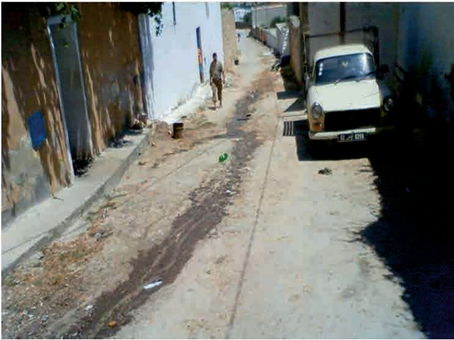
Eau d'égout fuyant d'un regard de visite endommagé (Beja)
