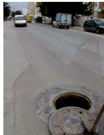
Photo: Conduite principale, Bizerte
