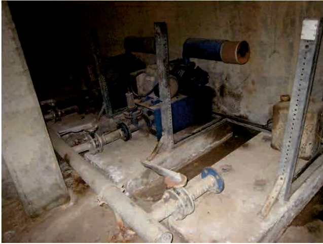
Compresseur hors service (STEP de Medjez el Bab)
