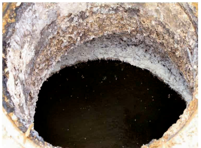
Réseau hors service pour cause de problème d'inclinaison (Sfax)
