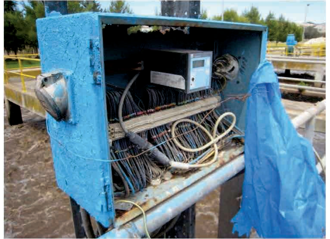
Coffret électrique sans couverture (STEP de Béja)
