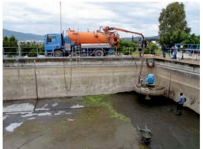
Bassins d'aération en cours de maintenance périodique (STEP de Tabarka)
