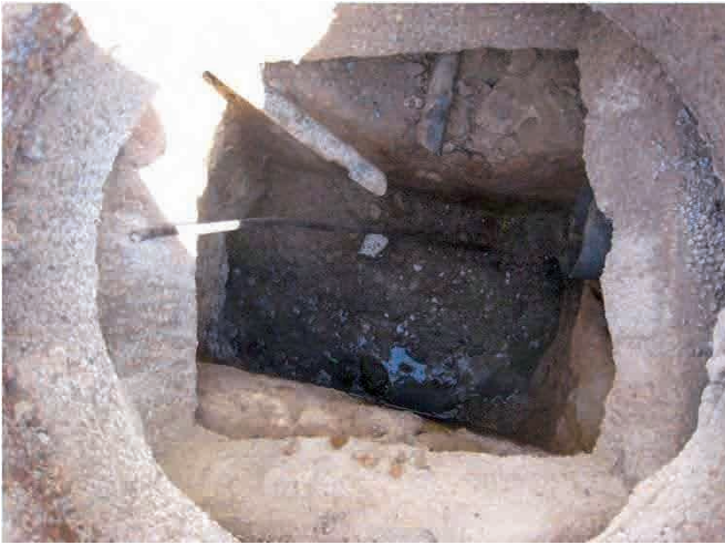
Connection inadéquate d'une habitation (Zaghouan)
