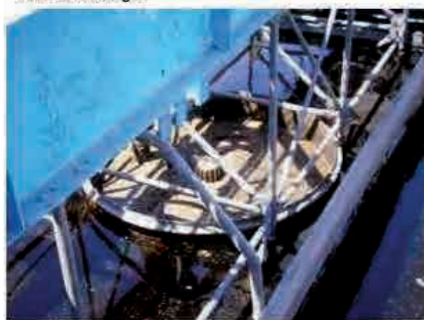
Pompe d'extraction des boues
