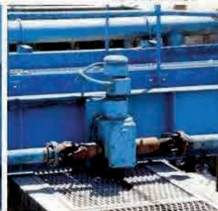
Motorisation du pont de raclage
