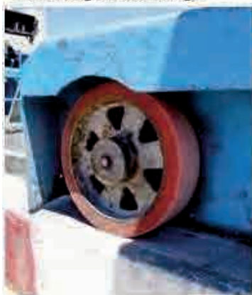
Roue du pont de raclage
