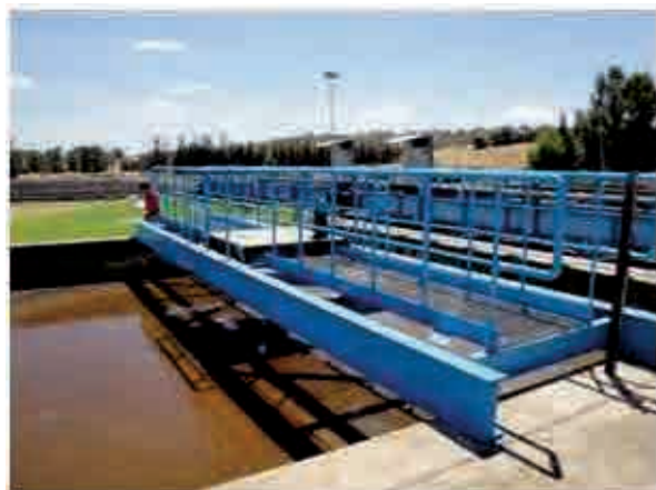
Pont de raclage du épaisseur
