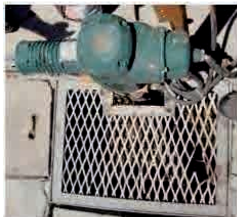
Vanne de répartition des boues
