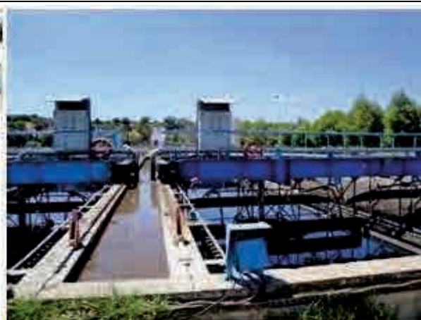
Chenal d'extraction des boues
