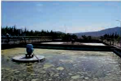
Aérateur de surface flottant
