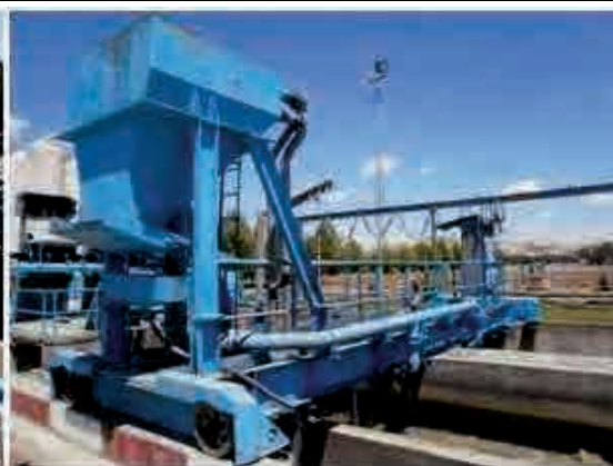
Pont de raclage
