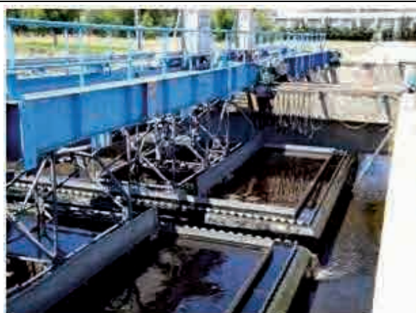
Pont de raclage
