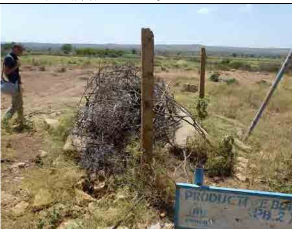
No.4 ジャラル溪谷給水システム 水源深井戸 ポンプが故障し使用出来ないなので、枯枝で覆っている。リハビリをして再稼働が必要。
