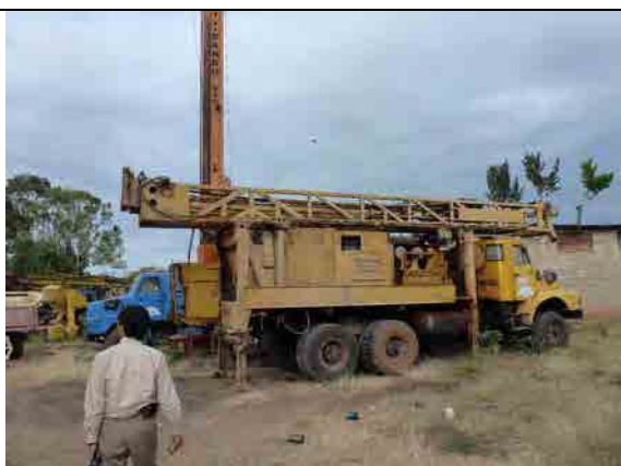
No.2 ソマリ州水公社資材置き場 サービスリグは水資源局から移管されて、現在は水公社が所有している。
