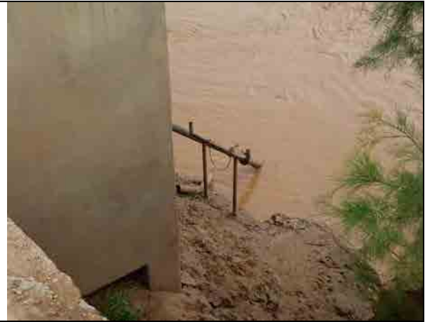
No.8 ゴデ市給水システム 取水施設 シェベレ川の水を中央にあるポンプから取水する。原水は濁度が高い。
