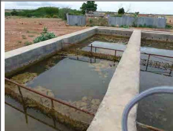
No.9 ゴデ市給水システム ろ過池 維持管理が適切に行われていないため、水面に藻が発生してしまっている。
