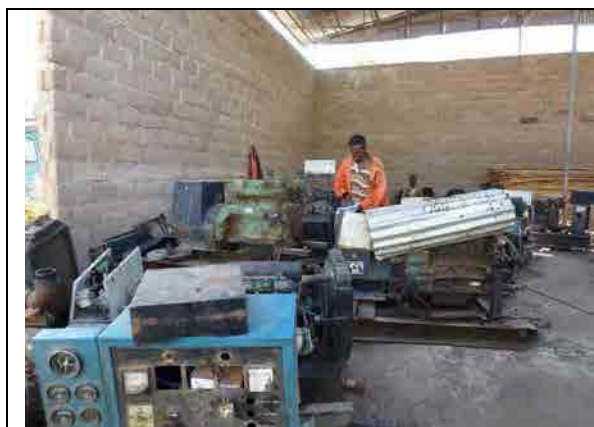
No.1 ソマリ州水資源局ワークショップ 故障したポンプや発電機等の設備が、雑然としたまま置かれている。
