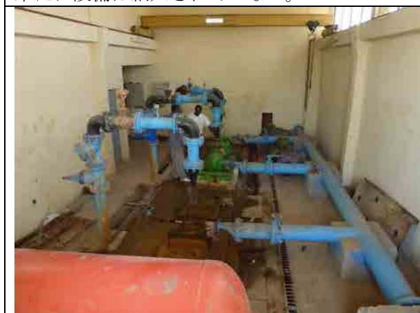
No.5 ジャラル溪谷給水システム ポンプ場 手前と奥のポンプが故障し、はずされている。稼働しているのは、中央の一台のみ。
