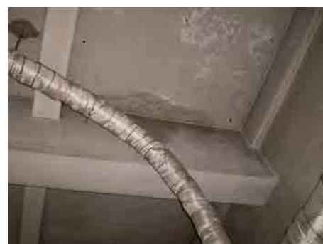
写-4 大梁の漏水状況
