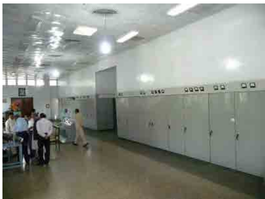
ファキラバード送信所の内部
