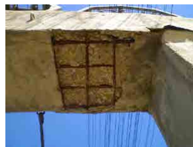
給電線支柱状況
