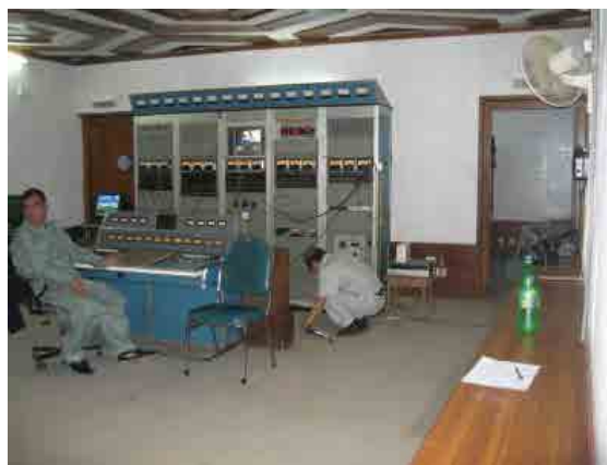
PBC 本局内マスターコントロールルーム
