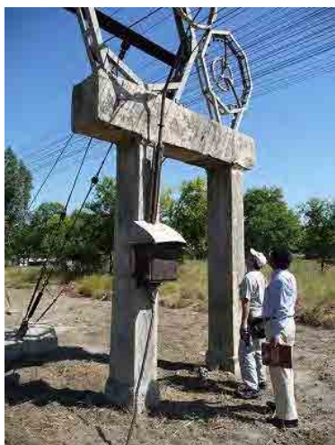
ファキラバード送信所の給電線
