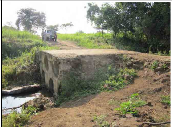
工事途中で中断している河川横断施設。
