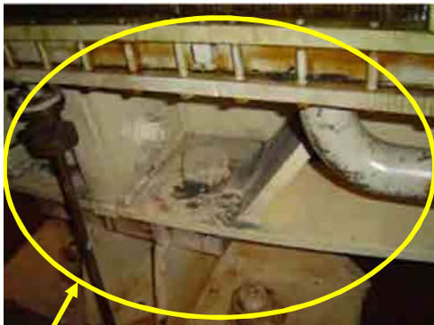
エア'クー'ラの汚れ及びステー'タ' -スの汚れ Photo 63
