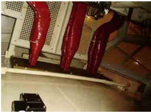
固定子より出口ニュートラルリード:目視点検:良 Photo 29
