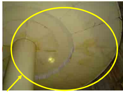
水車側より見た下部ブラケットガ-油付着状況 Photo 38
