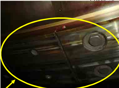
ブレーキング摺動面状目視では悪くはない Photo 21
