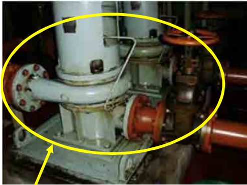
潤滑油ポンプケーシング部より油漏れ有り Photo 35
