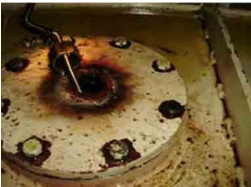
漏油の原因の一つ;エア-ボックス上の計器引きこみ穴 Photo 39
