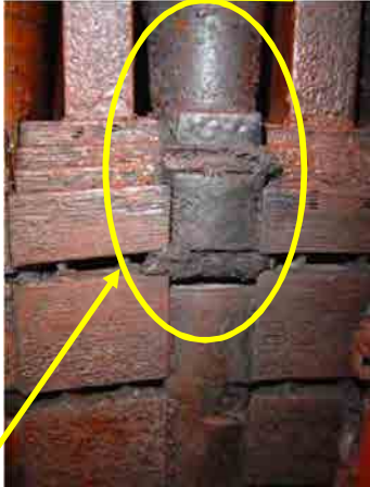
コイルとコアの変色及び汚れ状況 Photo 11
