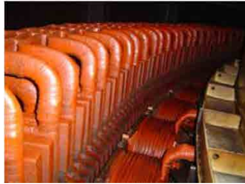
ステータコイルとロータコイルの状況 Photo 10
