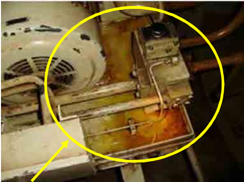
オイルワタ装置よりの油漏れが受け皿に有り Photo 19
