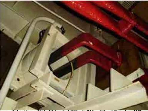
ラインリードとCT:目視点検:良 Photo 27
