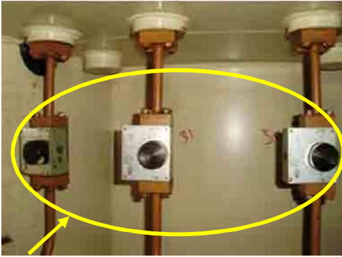
フローコントロールバルブよりの漏油チェックV不良も数個 Photo 17
