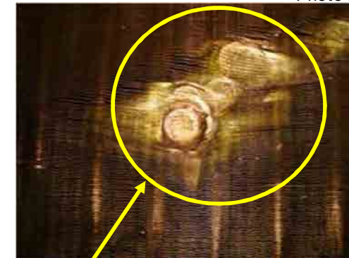
エアークーラの冷却用フィン圧痕損傷 Photo 24
