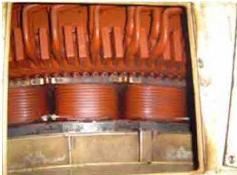
CLR側点検カ' -よりロ'タ'ステー'タ状汚 Photo 61
