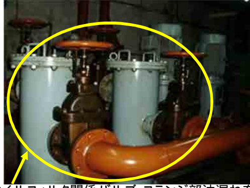
オイルフィルタ関係バルブ・フランジ部油漏れ有り Photo 34
