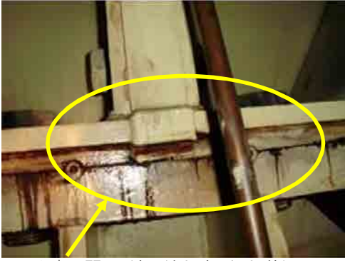
ステータース間より油の流れ出し汚れ状況 Photo 49
