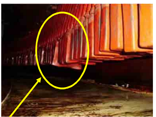
水車側絶縁キャップがズレ落ち
