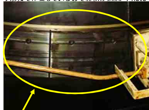
ブレーキング摺動面状目視では悪くはない Photo 22
