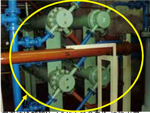
潤滑油冷却器No.1,3が不具合あり:油に水漏 No.2,4を使用している(容量不足) Photo 33
