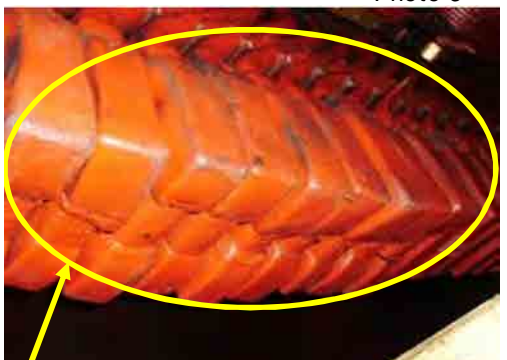
水車側セッインキャップの変形
