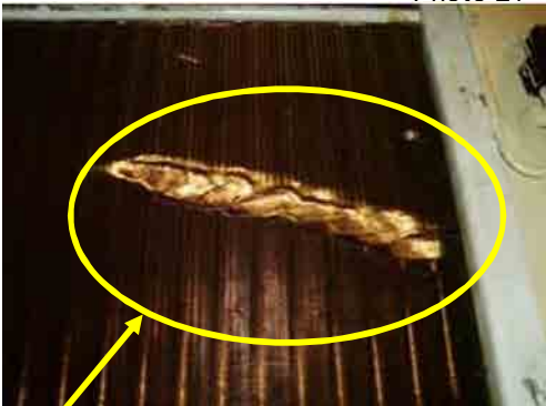
エアークーラの冷却用フィン圧痕損傷 Photo 23
