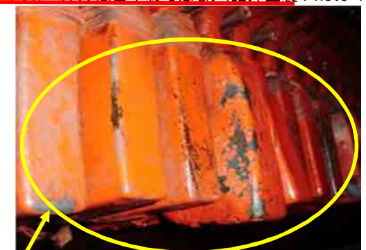
水車側セッインキャップの変形ワニス剥離
