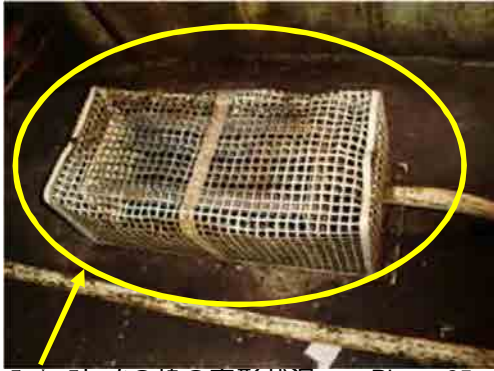
スパーヒータの枠の変形状況 Photo 25
