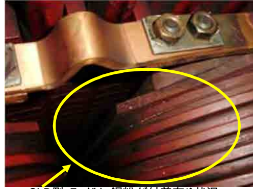
CLR側:Fコイルに銅粉が付着有り状況 Photo 58
