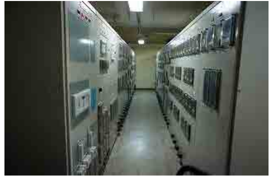
写真③ 継電器室
