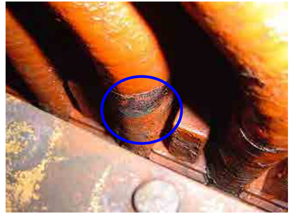
ステーターコイルエンド グラスファイバテープがコイルから剥離している。
