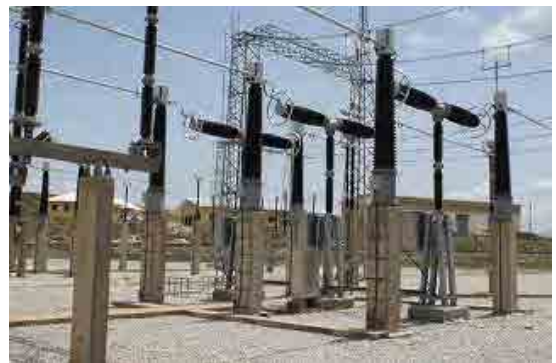
写真⑤ 330kV遮断器
