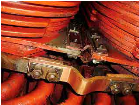
ロータ部（水車側）
