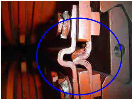
ローターポール部（コネクタ） ローターポール部において、極間コネクタの変形が見られる。
