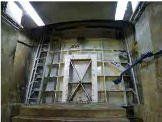
水車ドラフト部 水車室ドラフト部用点検ドア
