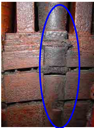
ステーターコイル端 フィールドコイルの絶縁カラーは過熱により変形している。
