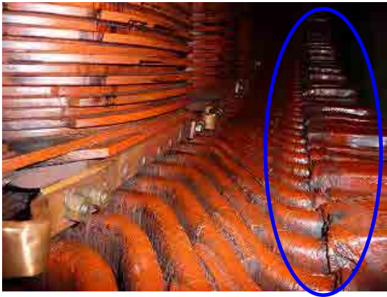
絶縁キャップ（水車側） ステーターコイルエンド部の絶縁部分は過熱により一部剥離が見られる。
