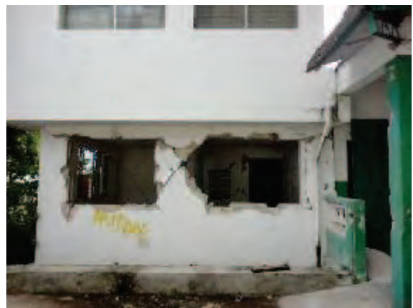
写真 2-6 使用不能となった検査棟 (2010.6 撮影)
