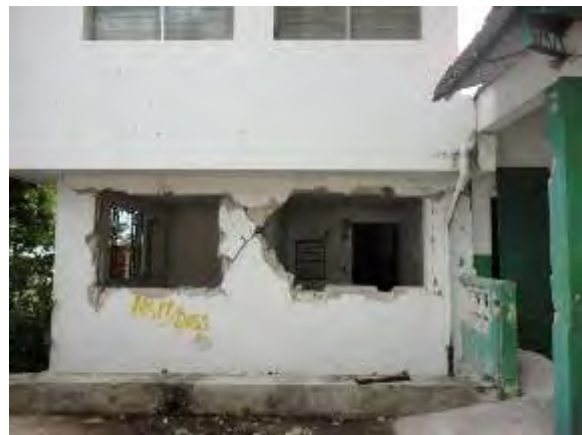
写真 2-6 使用不能となった検査棟 (2010.6 撮影)
