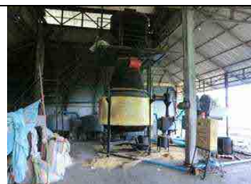
写真 18: Battambang の小規模精米会社: ボイラー
