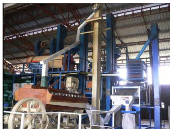
精米プラント
