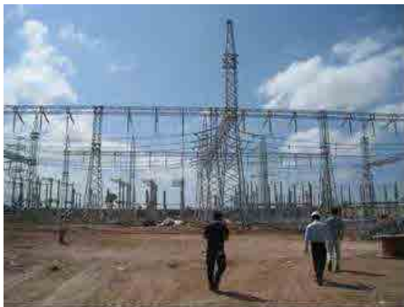
図 8 屋外変電設備の様子
