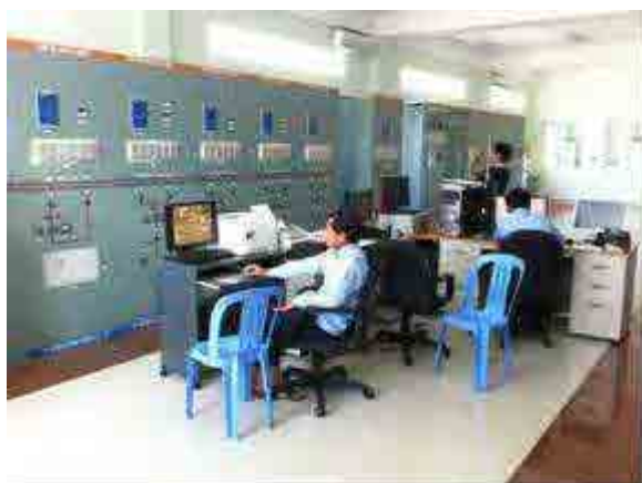
図4 コントロール室
