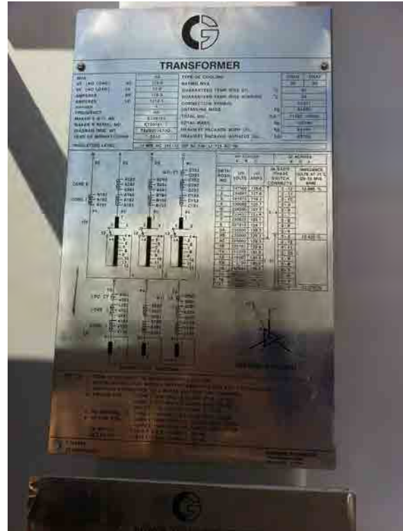
図 7 230/22kV 変圧器銘板
