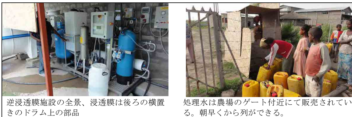
図 12.13: Meki 逆浸透膜ろ過施設
