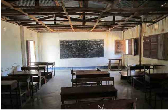
ES de Muecate: 小学校施設を転用して2006年に開校。教室内部の様子。天井が落ち、傷みが激しい。
