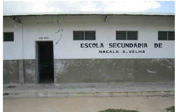
ES de Nacala-a-Velha: 組積造の外壁に大きなクラックが走っている。
