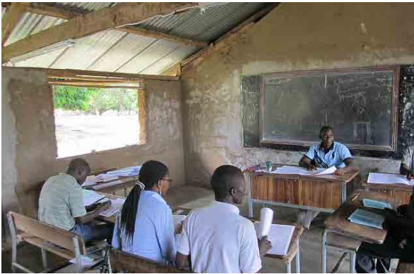
ES de Memba: 教室内部。窓・扉も無く、屋根トラスは間隔が広く構造的に十分な仕様を備えていない。
