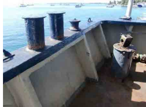
係船ビット腐食顕著
