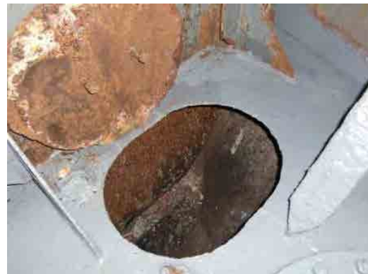
マンホールカバーの腐食が顕著
