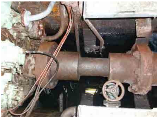
中間軸、フランジ継手が腐食 ビルジが溜まっている 船底構造材が腐食
