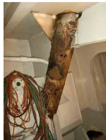
船尾チェーンパイプの腐食状態
