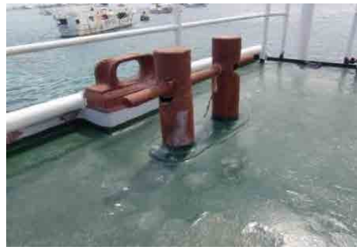
ビットに腐食の大穴
