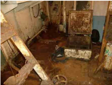
階段ステップは錆びで欠落
