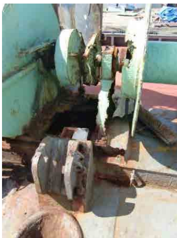
ウィンドラスの部品が錆び落ちている
