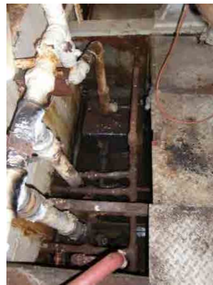
機関室配管に錆び
