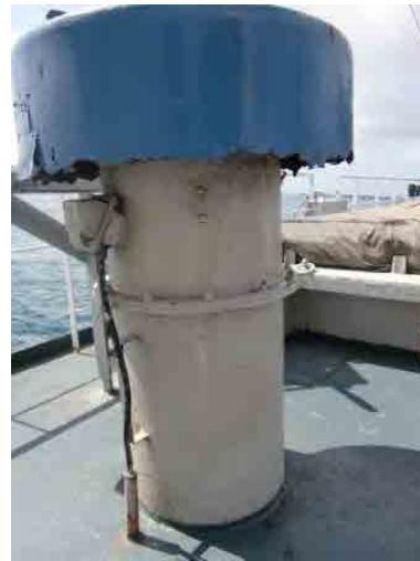
錆びた通風機
