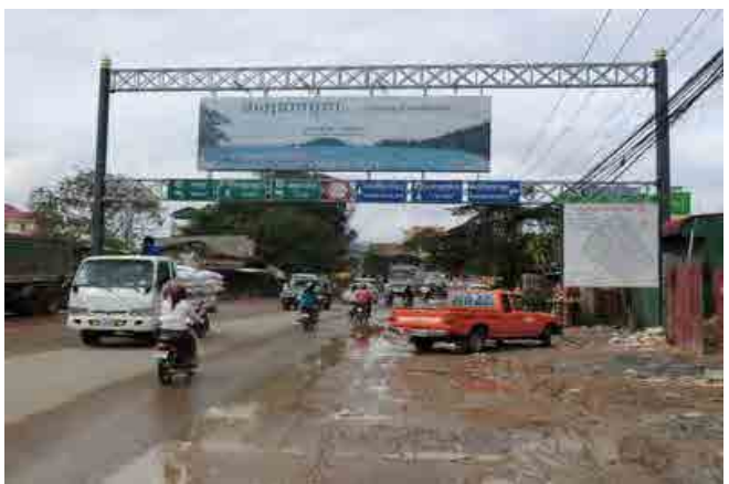
Sta. 1+200 付近 路肩の損傷状況
