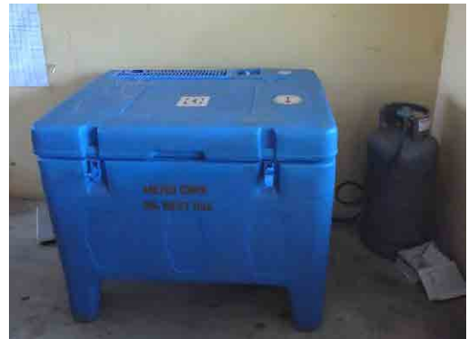
同左。診察室に置かれたワクチン用冷蔵庫 (ガス式)。
