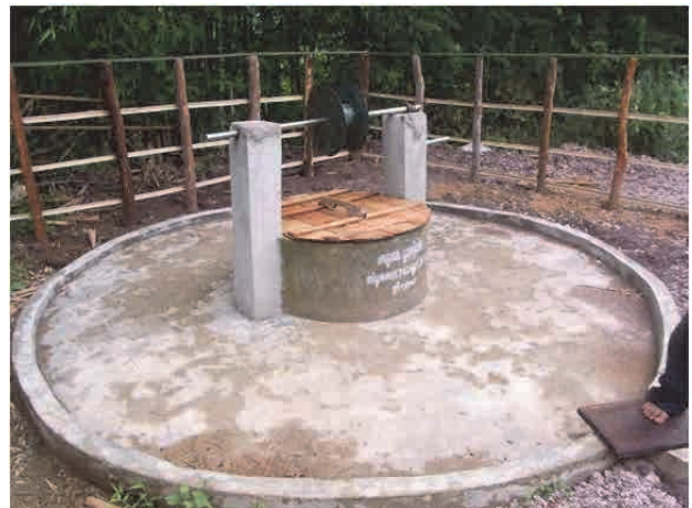
パイロット事業で建設されたブンサイ郡の井戸
