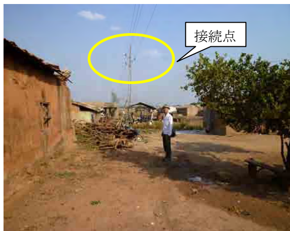
11.5kV 配電線接続地点の様子
