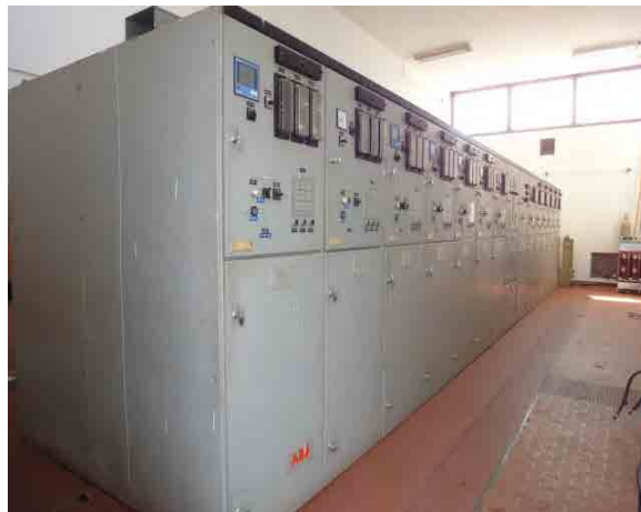
34.5kV 遮断器盤の外観
