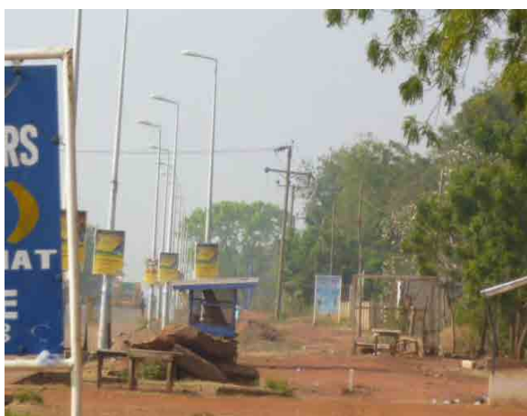
34.5kV 配電線ルート(市街地)の様子
