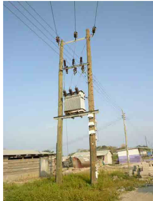
⑥ 配電用変圧器（イエジ）
