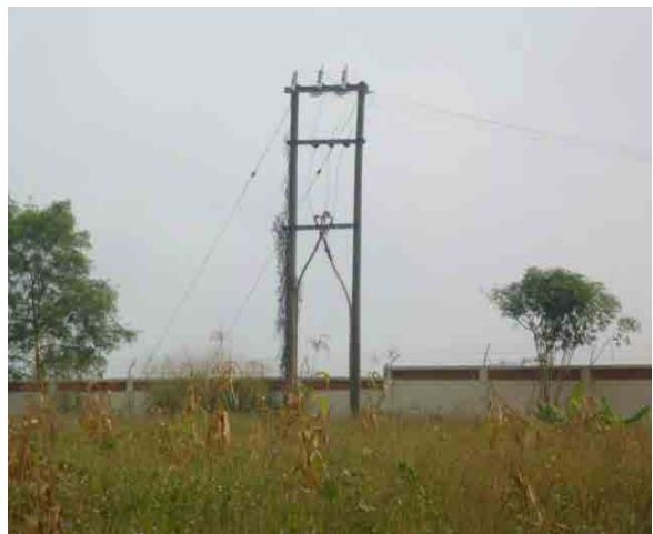
スンヤニ州病院内配電盤設置予定地の様子
