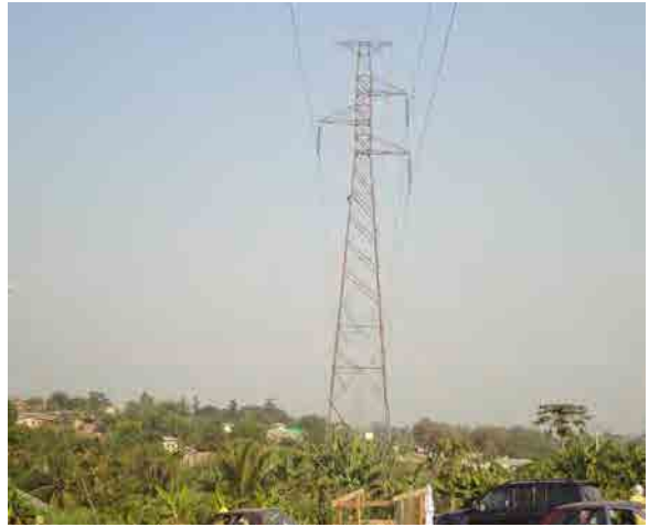
161KV 基幹送電線の様子
