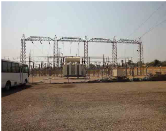
タマレ境界変電所の概観
