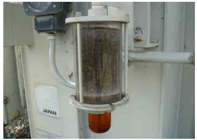
④ 交換されたばかりのシリカゲル（5MVA 変圧器）
