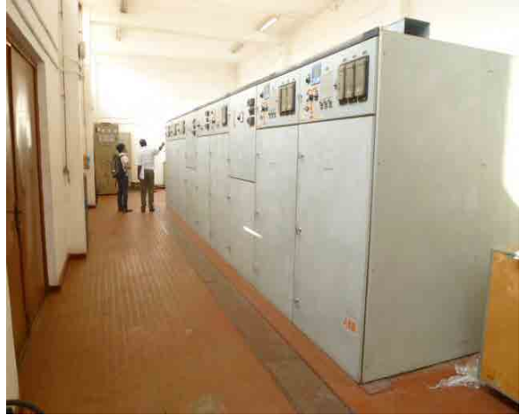
34.5kV 遮断器盤の外観
