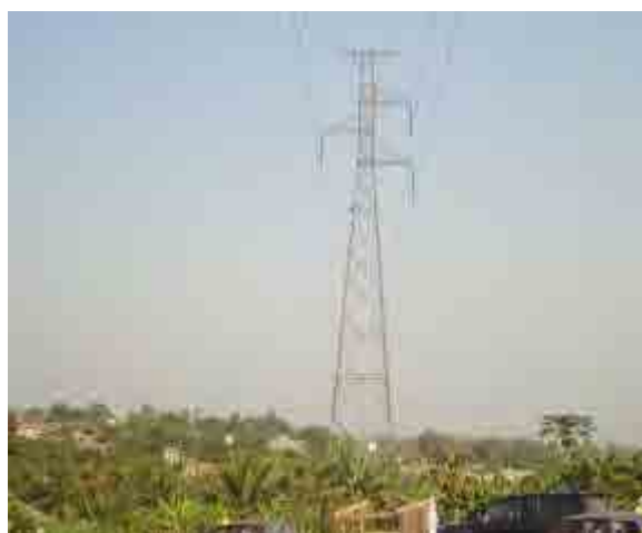
161KV 基幹送電線の様子
