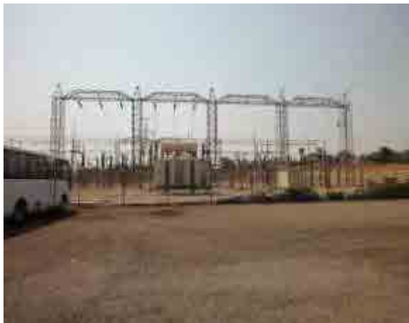
タマレ境界変電所の概観
