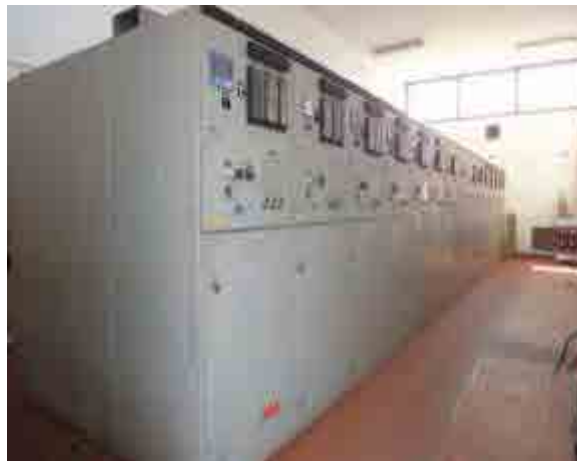
34.5kV 遮断器盤の外観
