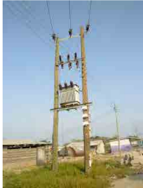
⑥ 配電用変圧器（イエジ）
