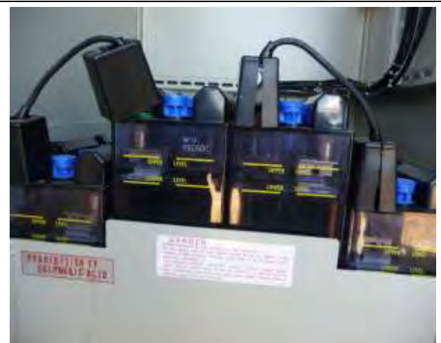
⑪ 33kV 屋外型金属閉鎖配電盤内のバッテリー電解液量は適切に管理されていた。
