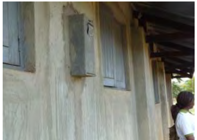
④ ナムンガルウェの小学校では、メーターボックス及び内部配線も完了し接続待ちの状況であった。
