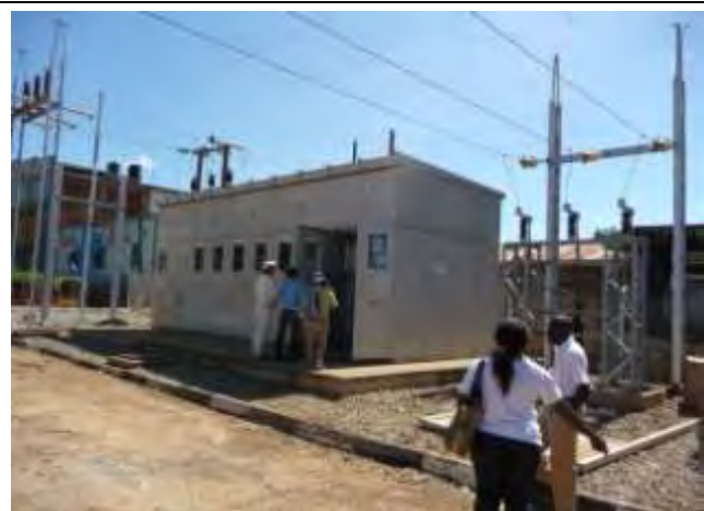
⑩ 既存イガンガ変電所内に設置された 33kV 屋外型金属閉鎖配電盤は UMEME により良好に維持管理が成されていた。
