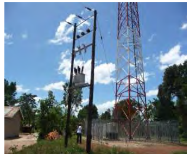
⑥ ナビテンデにある民間携帯電話会社（MTN）の施設には、柱上変圧器（33kV/415-240V、50kVA）を設置し、低圧配電線が引込まれていた。
