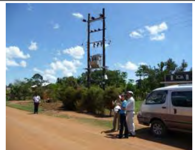
⑫ 配電用変圧器（33KV/415-240V、100kVA）も良好に管理されていた。（ナムンガルウェ）
