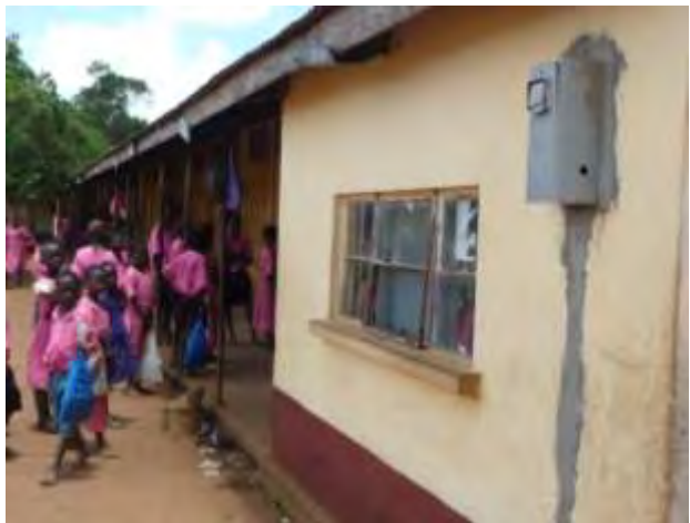
③ キワニの小学校では、メーターボックス及び内部配線も完了し接続待ちの状況であった。
