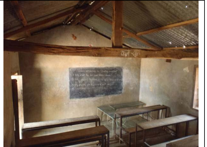
写真-10 同左(既存棟) 既存教室棟は天井高さが不十分で、採光、換気が悪いため無償資金協力による教室棟のほうが学習環境がよいという評価であった。既存棟は構造的にも脆弱である。
