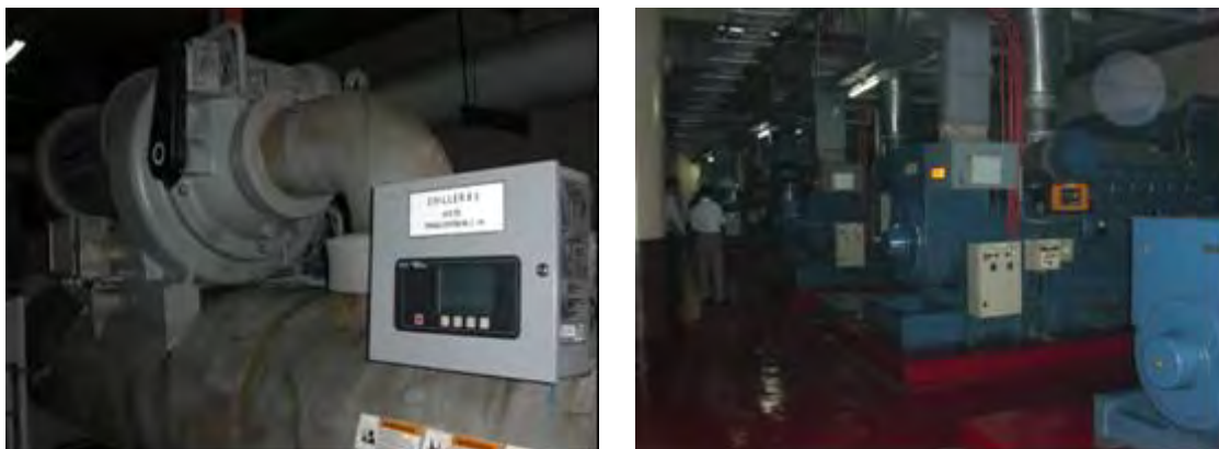
図 4.6-3 電気式チラー（左）と自家発電機（右）
