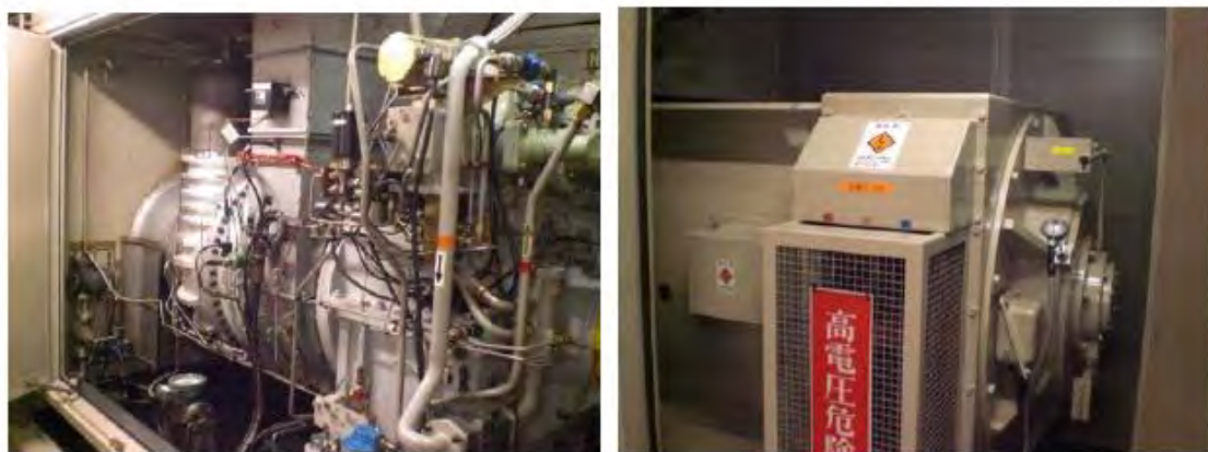
図 4.6-2 コージェネレーションシステムのガスタービン (左) と発電機 (右)
