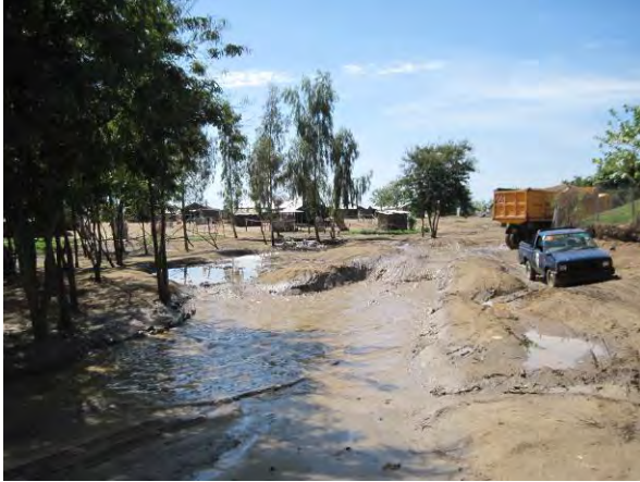
ジュバ市内環状道路 (C3) (排水不良により損傷する道路)
