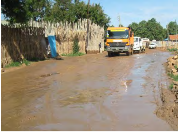
図 3-3 排水不良による道路の冠水
