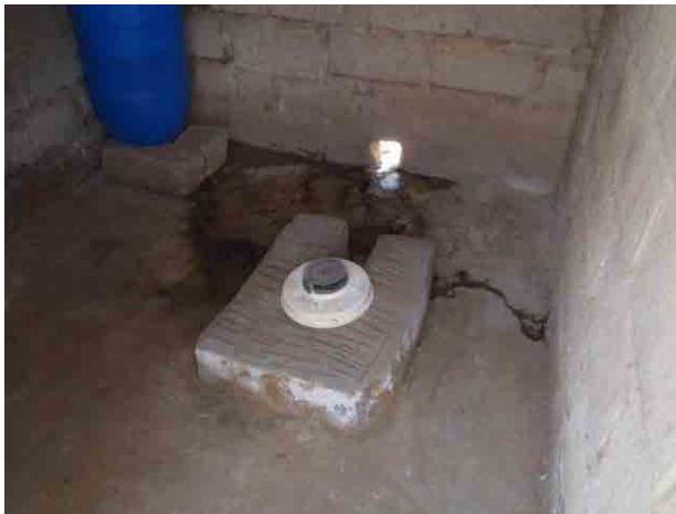
Celing 村 蓋付きトイレ①
