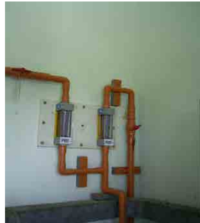
前塩素と後塩素の制御装置 (シアヌークビル浄水場)
