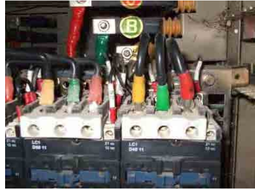
取水ポンプ盤内
