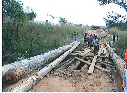
Chicava 地区内の主要道、修理中の木橋
