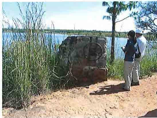
取水施設 損壊している
