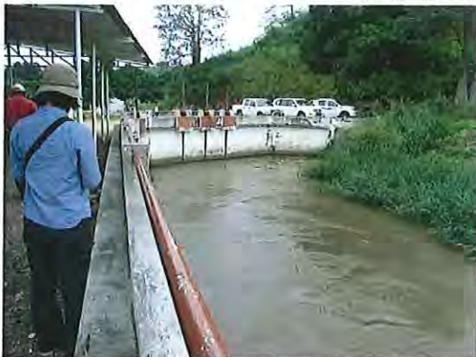
取水施設。河川右岸側にあり3門のゲートがある。最大取水量は 3.8\text{m}^3/\text{s}
