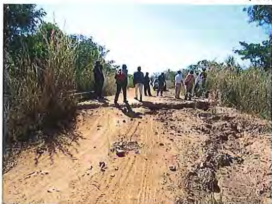
水路横断工。水路は草木に埋もれ確認できない
