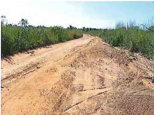
Bie州Chikavaダムへ通ずる二次道路 雨水による洗掘が多い
