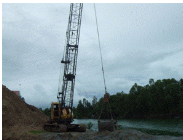
写真 5.4.2.3.3 バージ船積み込み設備
