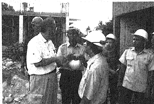
Un experto japonés asesora a las personas locales en las obras de construcción.
