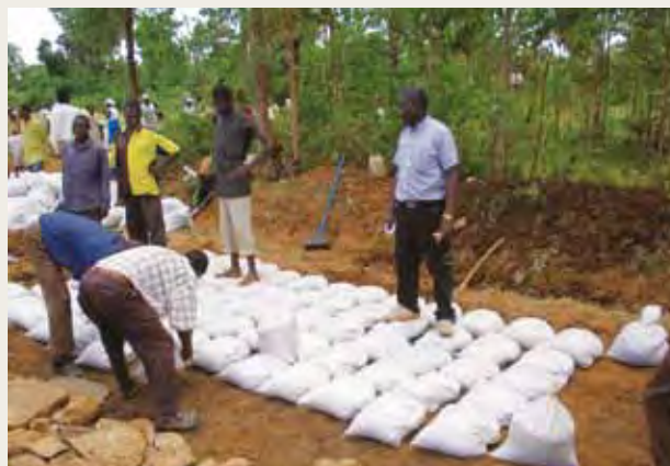
Un groupe d'agriculteurs restaure une route du village à l'aide de sacs de sable. Cette activité réalisée en commun a contribué à resserrer les liens du groupe.
