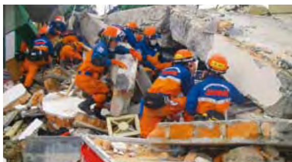
Activités de recherche dans un bâtiment effondré
