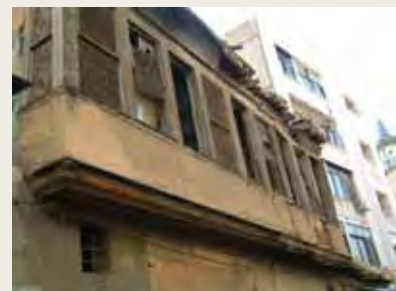
Construction vieillissante à Qanawat
