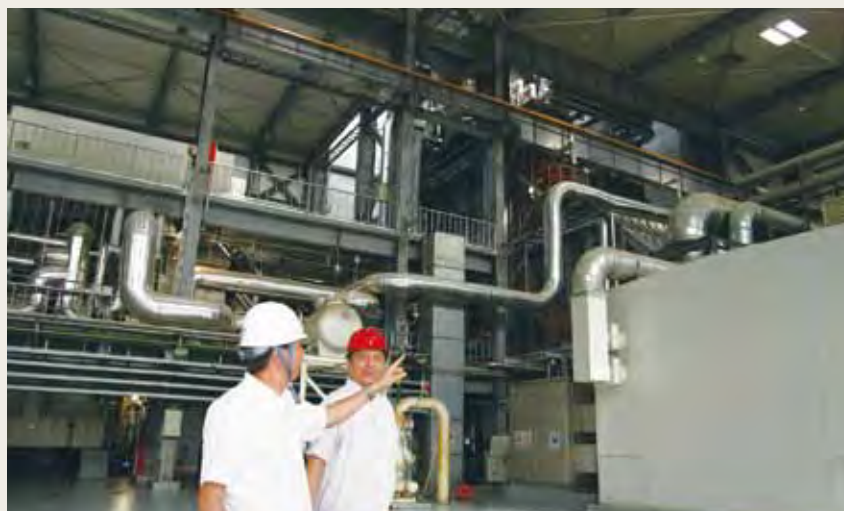
Nouvelle installation de cogénération. Afin de réduire les nuisances sonores produites par cette installation pour les riverains, la turbine à gaz a été enfermée dans un grand boîtier (en bas à droite).
