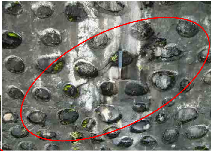
道路山側擁壁に亀裂が生じている。
