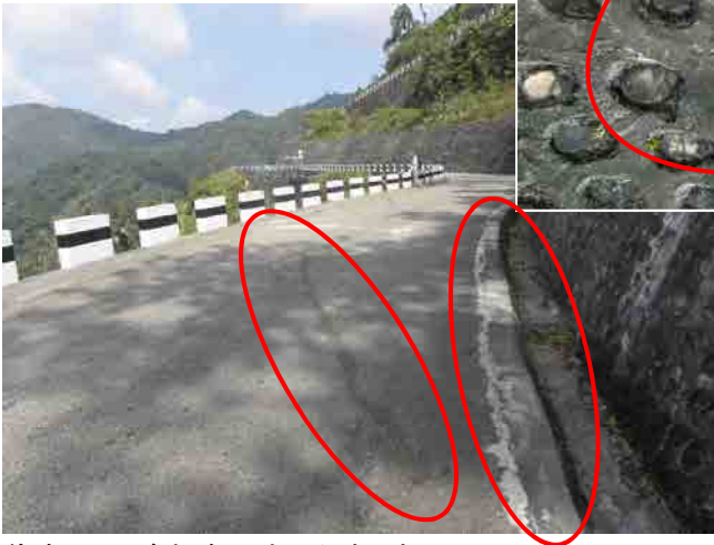
道路面及び水路に生じた亀裂。
