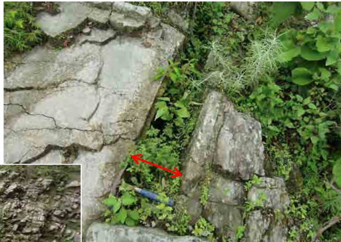
Bブロック頭部の岩盤の開口亀裂。
