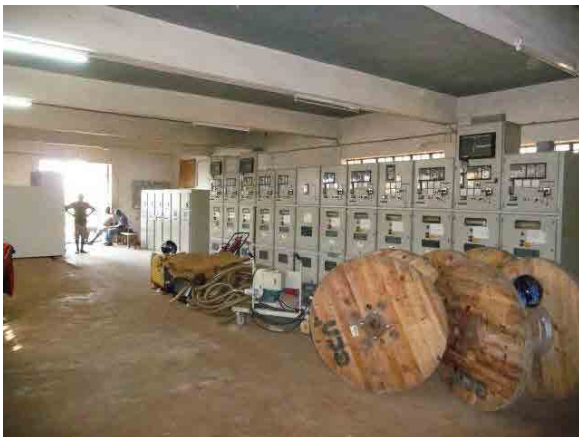
Wilberforce 変電所コントロール室内の様子①
