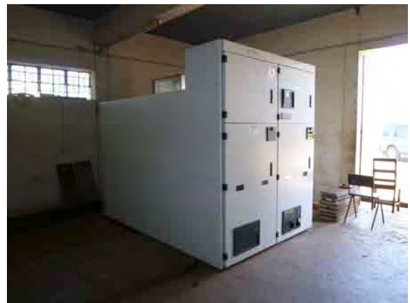
Wilberforce 変電所コントロール室内の様子②
