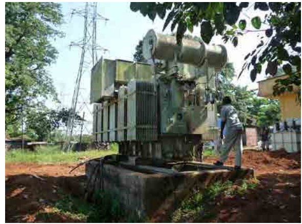
Wilberforce 変電所の既設主変圧器の様子
