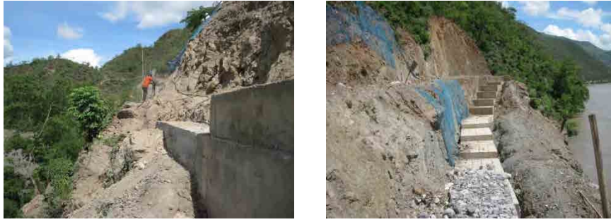
図 2-8 地形・支持地盤を確認しながら擁壁工事をしている例 (左:第三工区(1/2期)STA.27 付近、右:同 STA.1 付近)
