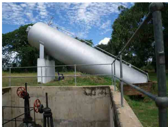
Walker's Ferry 取水・浄水・ポンプ場の急停電時の逆流防止用圧縮空気タンク (撮影日: 2011年3月6日)
