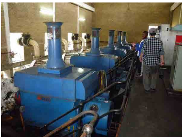
Walker's Ferry 取水・浄水・ポンプ場のポンプ (撮影日: 2011年3月6日)
