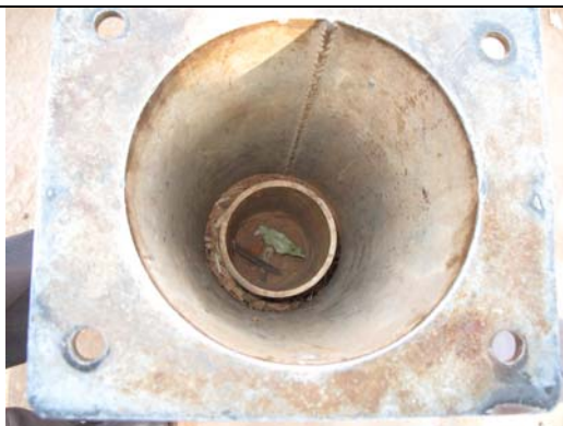
写真-9：ポンプヘッド上部が撤去され、ケーシング内部まで土砂で埋まった井戸。修繕は不可能。
