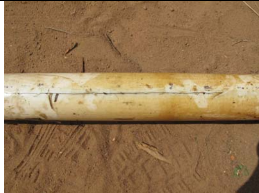
写真-8：揚水管（PVC製）に発生した亀裂。腐食、変形した軟鋼製ポンプロッドが揚水管の内面に接触することにより発生したと考えられる。稼動している井戸でも潜在的に同様な損傷が想定される。
