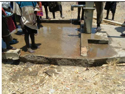
写真-12：周辺部が破損している付帯構造物。利用者（村落住民）による修理・補修を基本原則とし、本プロジェクトでは修理しない。
