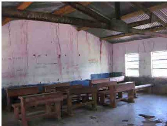
既存教室内観 床や壁の補修が必要な状況にある。
