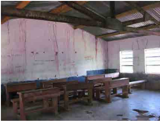
既存教室内観 床や壁の補修が必要な状況にある。
